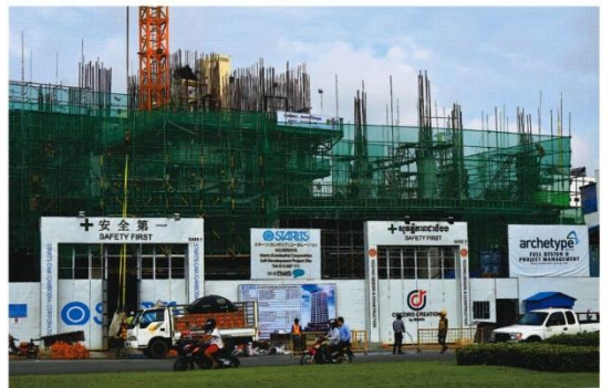
「ホテルエミオンプノンペン」の建設現場 ＝カンボジア・プノンペン
