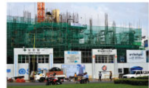
「スタートプノンペンホテル(仮称)」の建設現場。19階建て、総客室数240室、日本品質のホテルが開業する=プノンペン市内で
